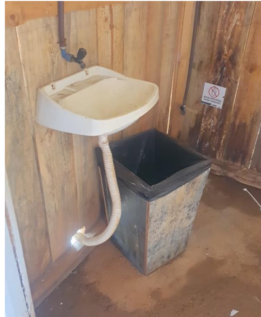
Figura 4 - Banheiro fixo na CGH Tapera 2A.
