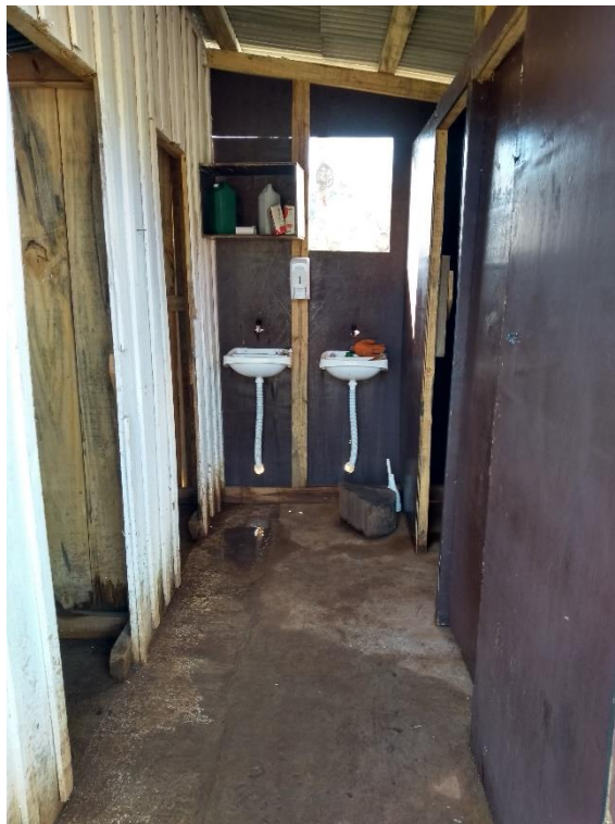
Figura 4 - Instalação sanitária fixa na CGH Tapera 2A.
