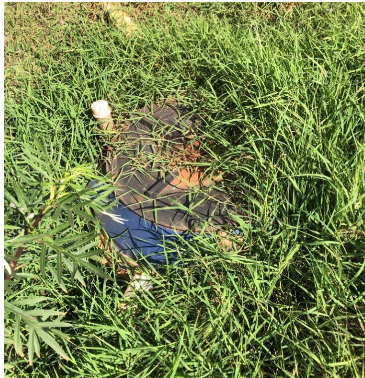
Figura 5 - Biodigestor instalado na CGH Tapera 2A.
