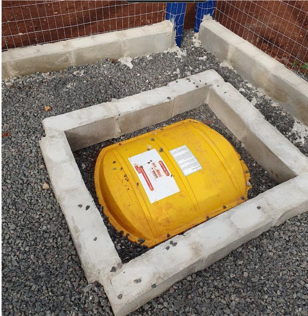
Figura 6 - Caixa separadora de água e óleo.
