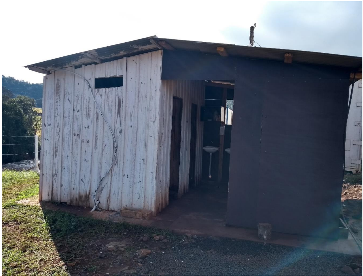
Figura 3 - Instalação sanitária fixa na CGH Tapera 2A.
