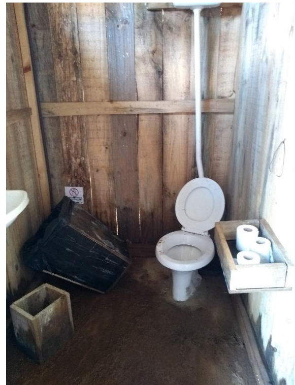
Figura 5 - Instalação sanitária fixa na CGH Tapera 2A.
