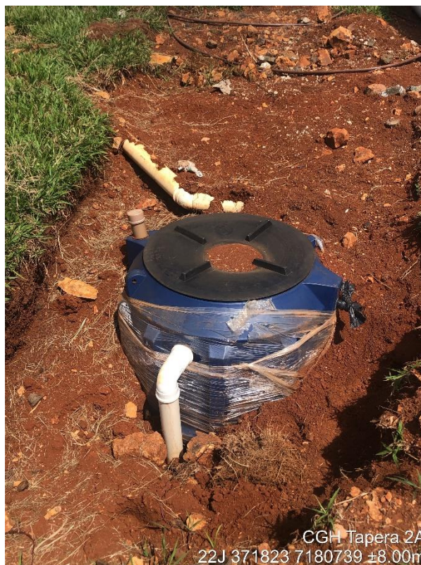
Figura 4 - Fossa séptica instalada na CGH Tapera 2A
