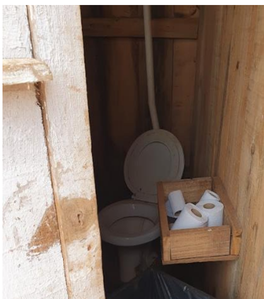
Figura 4 - Banheiro fixo no canteiro de obras.
