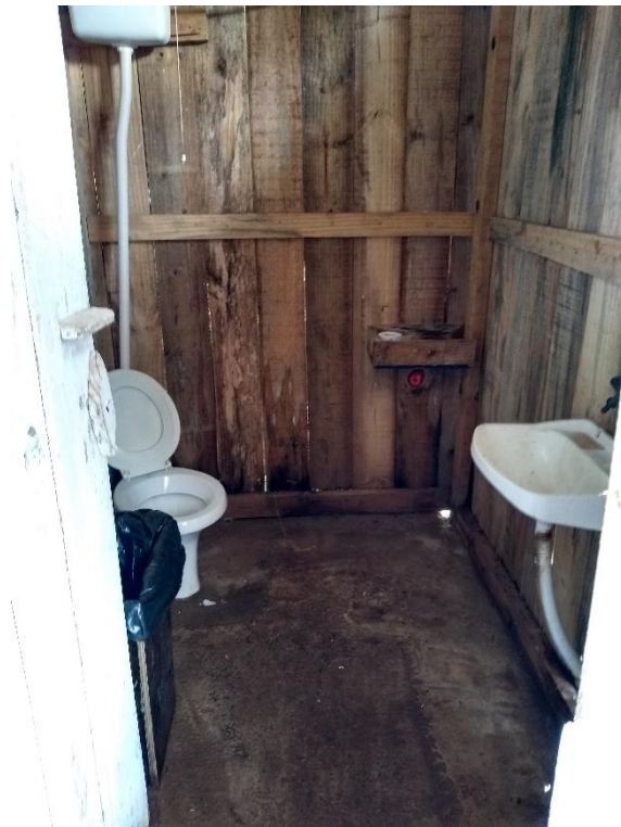
Figura 6 - Instalação sanitária fixa na CGH Tapera 2A.
