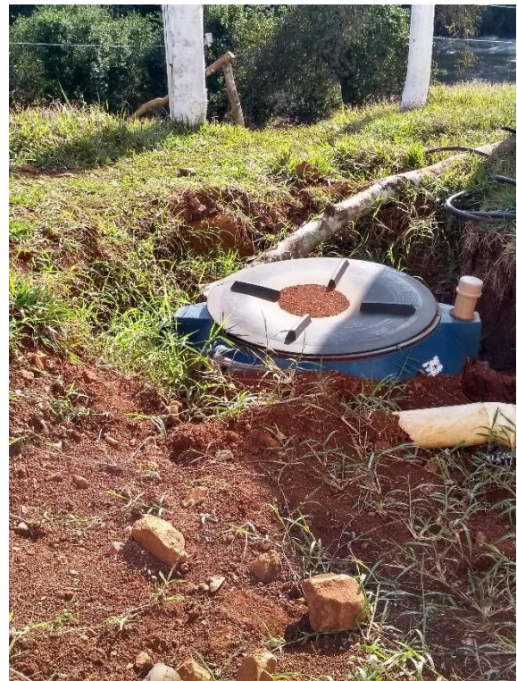
Figura 7 - Fossa séptica instalada na CGH Tapera 2A.
