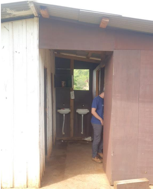
Figura 3 - Banheiro fixo na CGH Tapera 2A.
