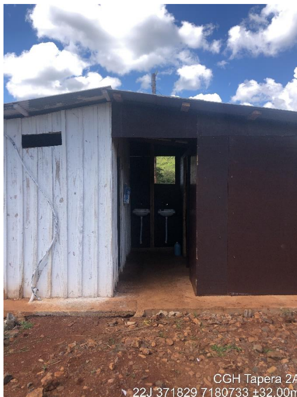
Figura 3 - Instalação sanitária fixa na CGH Tapera 2A.
